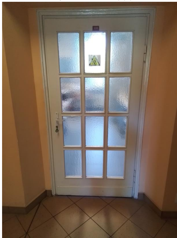
Istniejące drzwi w Katedrze Patologii
