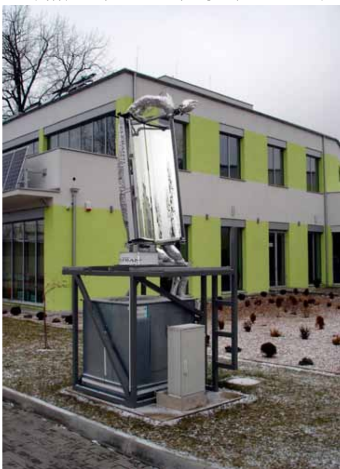
▼ Skupiający powietrzny kolektor słoneczny zintegrowany z akumulatorem ciepła
